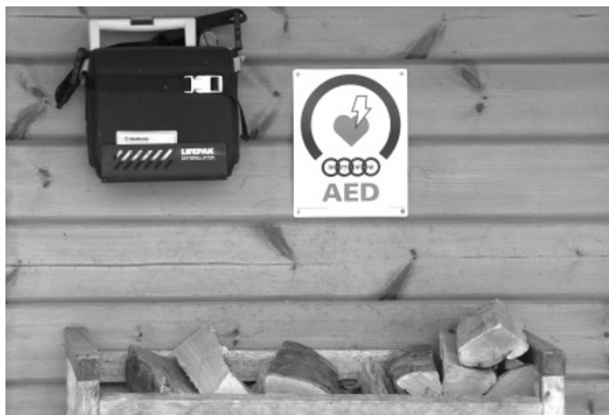
■ Abb. 4. Installation eines automatisierten externen Defibrillators im Außenbereich von LAGO-Die Therme in Herne. AED und Hinweisschild müssen gut sichtbar platziert und im Notfall sofort griffbereit sein.
